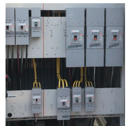
MCCB 取付標準パネル
