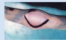
圧縮機の吐出し配管の破裂
