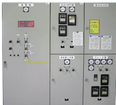
単要素の保護継電器を使用した配電盤
