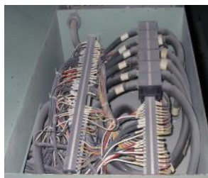
ジョイントボックス内ケーブル劣化、端子状況確認
